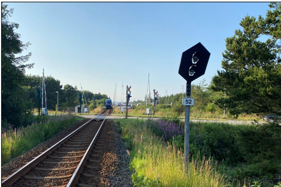
Foto 4. Slukket overkørselssignal A.01.2 ved overkørsel 52.
