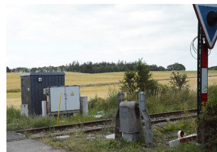
Bomdrev (B3) med spids henliggende bom. ”Løst kabel på vejsignalet.
