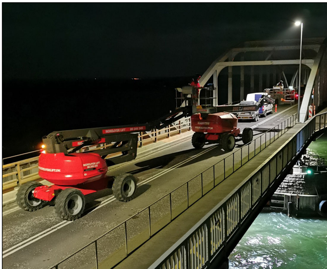
Foto 1 Liftene – med højt løftede kurve - på vej til arbejdsplads på broen. Optaget få minutter før ulykken.
