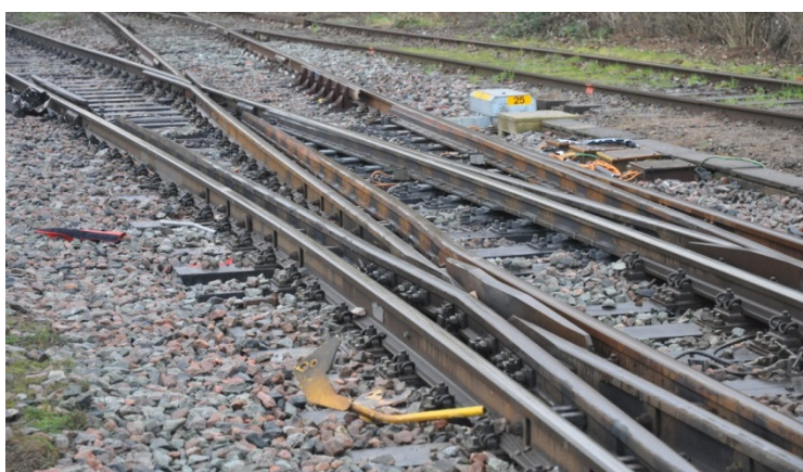
6 Skader i bl.a. tungepartiet i krydsningsspor 25 /24a
