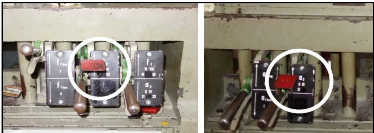
Abb. 6: Fahrstraßenhebel mit Hilfssperren
