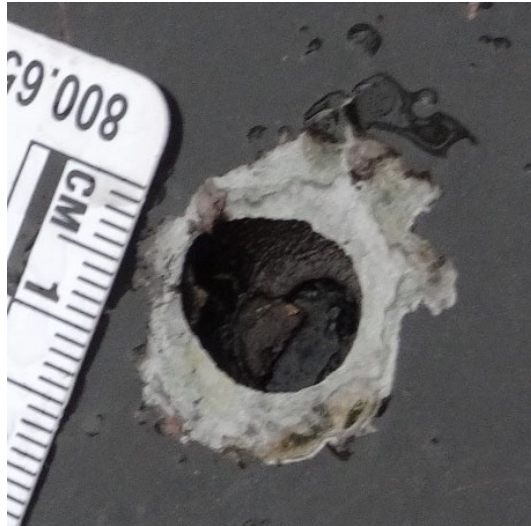
Abbildung 6: Ausprägung der Lochstelle im Stahlmantel.
