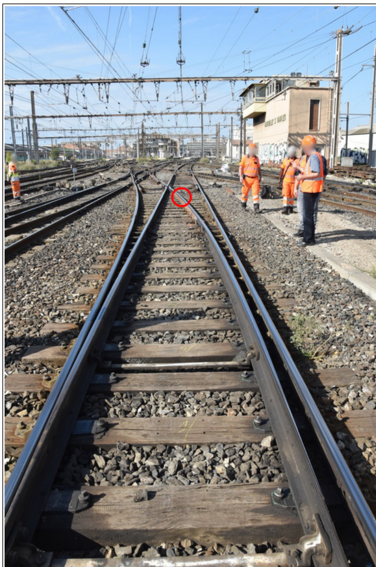
Figure 8 : branchement simple n° 312a en gare de Marseille, à déviation à gauche. Cerclé en rouge, l'emplacement de la rupture de rail.
