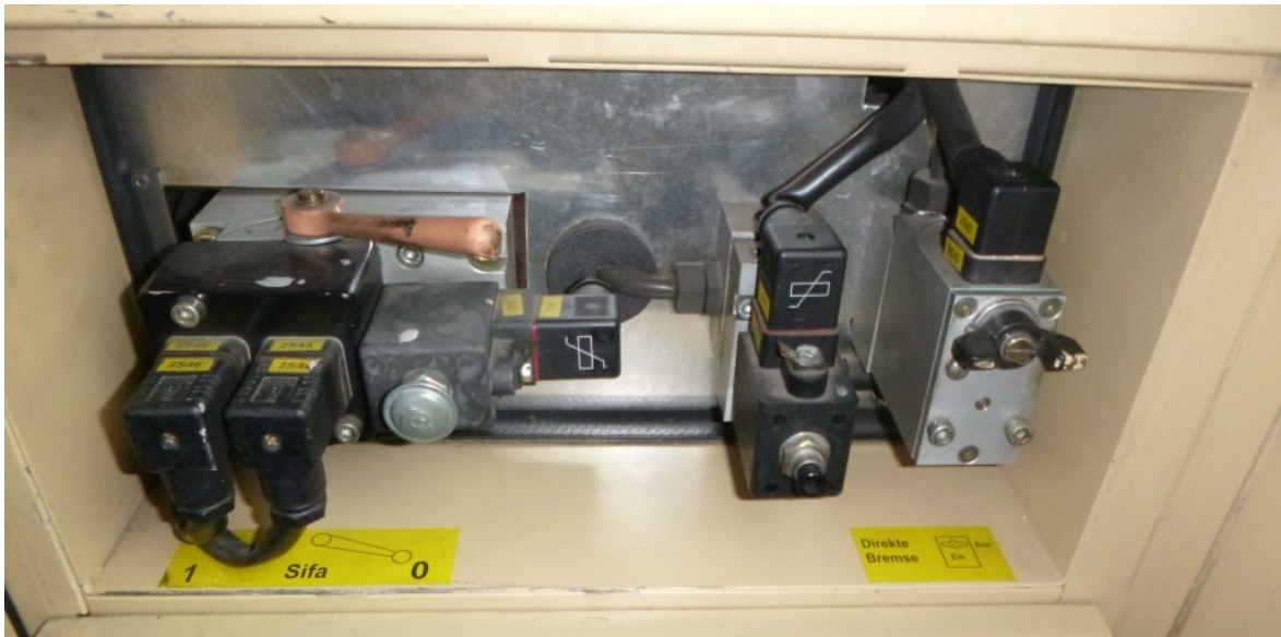
Abbildung 22 Ansicht des SIFA Absperrhahns und der ZuBas
