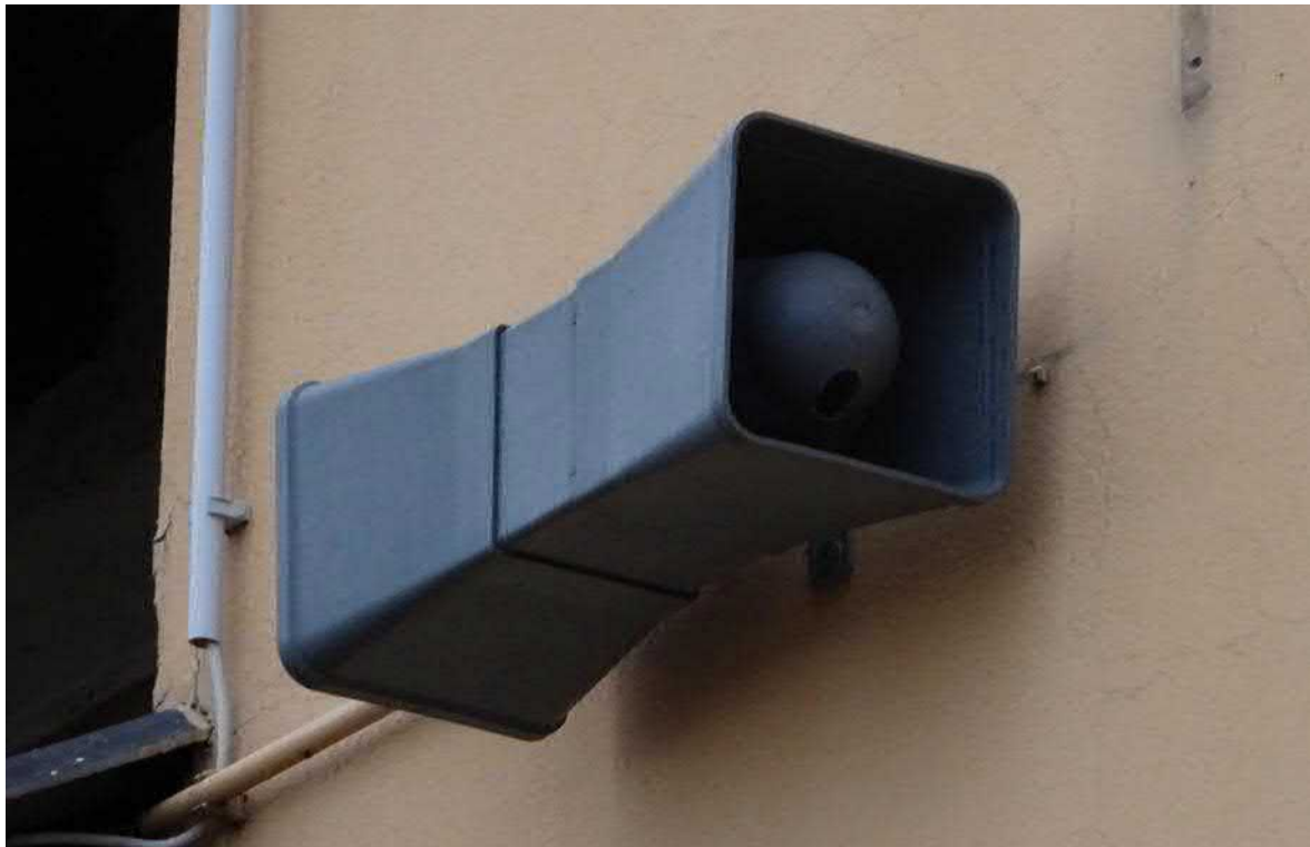
Abbildung 13 Im Außenbereich montierter Lautsprecher
