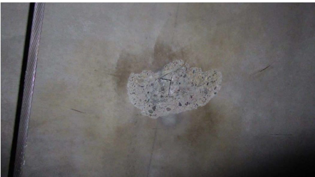
Abbildung 16: Einschlagspur der Seiteneinstiegstür an der Tunneldecke (Quelle IM)
