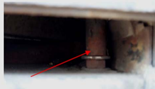
Schraubenmutter - nachträglich eingebaut
