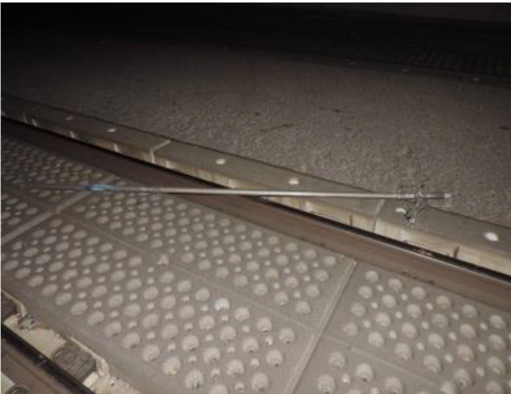
Abbildung 18: Stützrohr des beschädigten Oberleitungsauslegers (Quelle IM)
