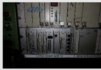
Türsteuerung und Gleitschutz
