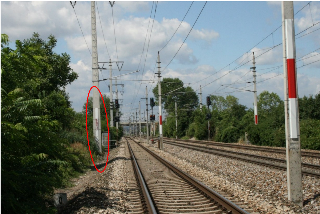
Abbildung 18: Sicht auf die ES Bf Leopoldau (Quelle SUB)
