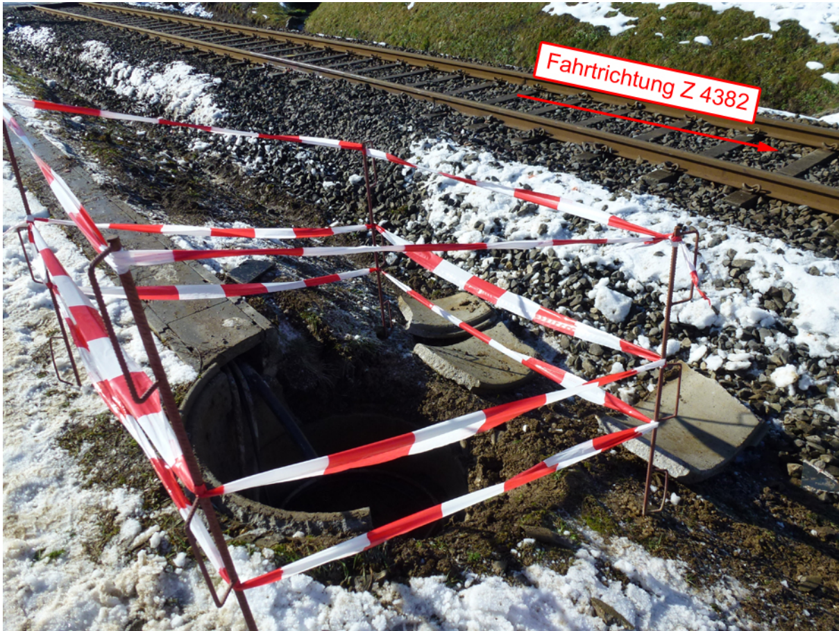
Abbildung 8: Beschädigter Leitungsschacht nach der Absicherung (Quelle SUB)
