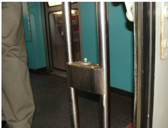
4. ábra A távzáró kapcsoló elhelyezése
