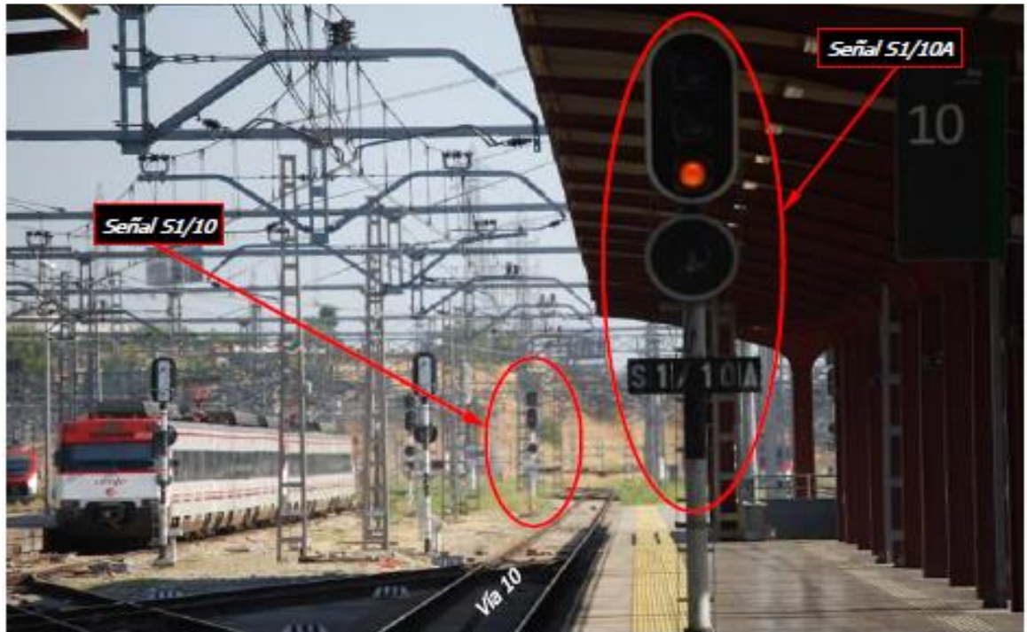
SEÑALES DE SALIDA S1/10A Y S1/10. (Fuente RENFE)
