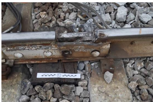
Giunto rotto al km 13+400 (fonte: Polizia Scientifica)
