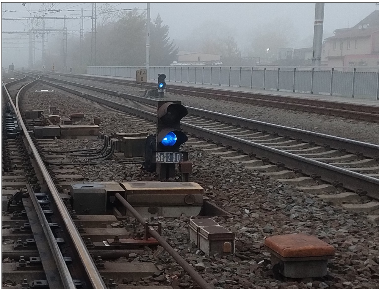
Obr. č. 4: Seřaďovací návěstidlo Se20 žst. Přerov
