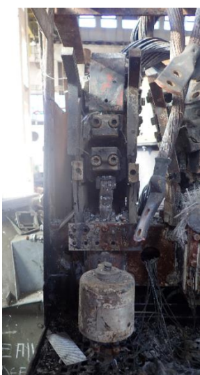
Foto nr.5 Contactorul S3.1
