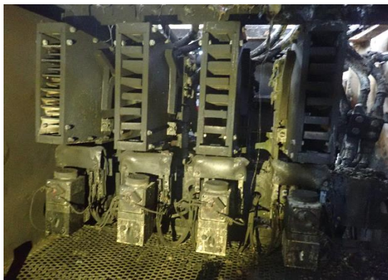
Foto nr.1 Blocul de aparate S1
