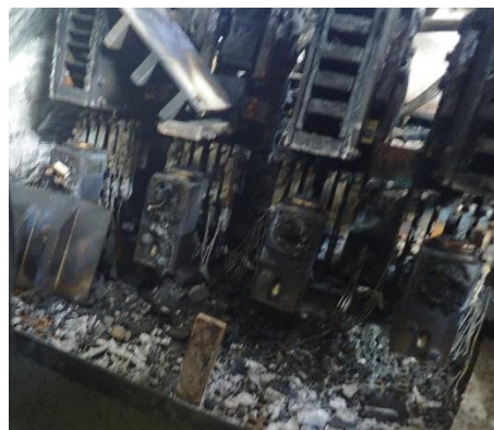
Foto nr.2 Blocul de aparate S2
