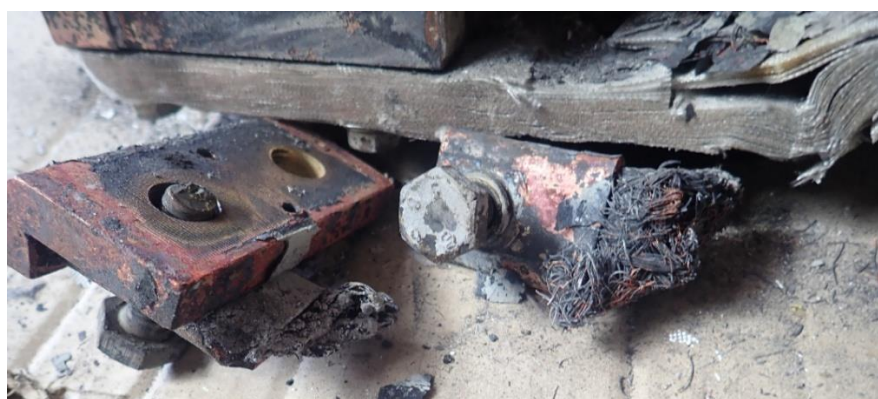
Foto nr.10 Conexe flexibile multifilare aferente contactului mobil prezintă un mănunchi de fire rupte
