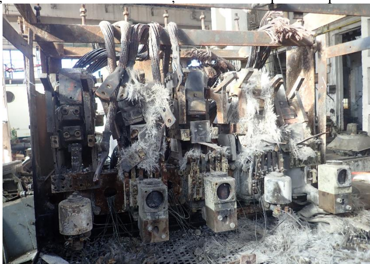
Foto nr.3 Bloc aparate S3
