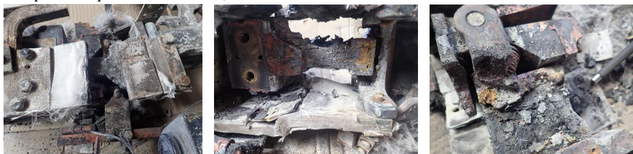
Foto nr.7,8 și 9 Contactorul de linie S 3.3
