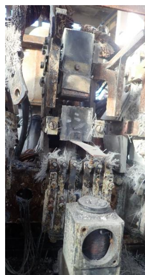
Foto nr.6 Contactorul S3.3
