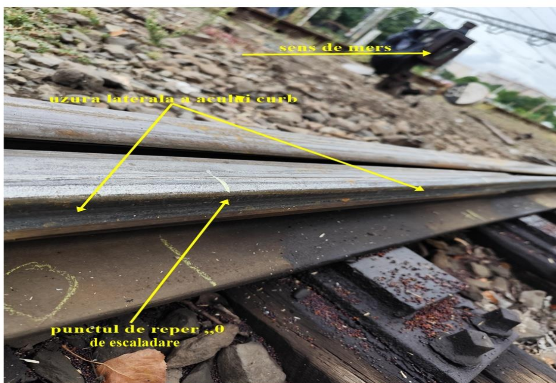
Foto nr.14 – punctul de reper „0” al accidentului feroviar (pe acul curb al schimbătorului de cale)
