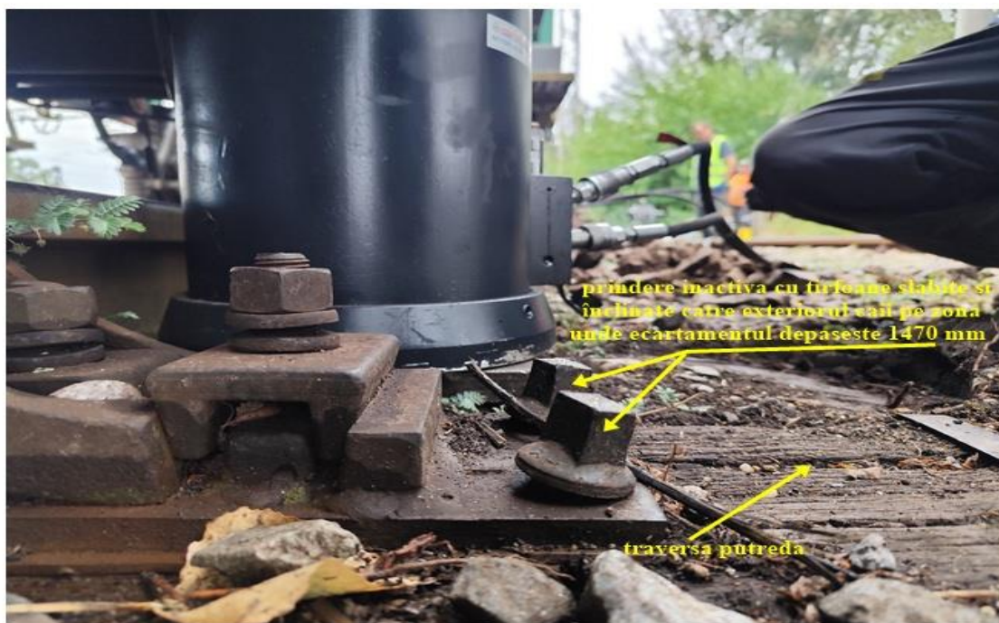
Foto nr.22 – prindere inactivă placă metalică – traversă
