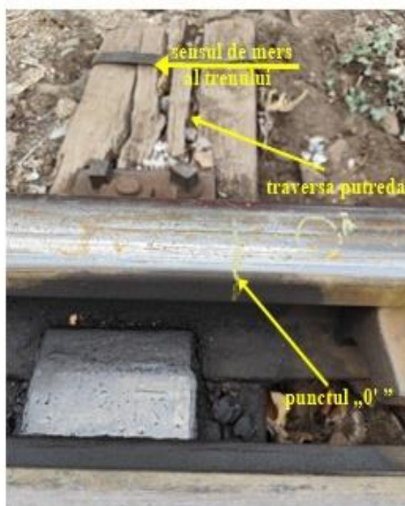
Foto nr.19 – punctul de reper „0” al căderii între ac și contraac a osiei aferente vag.nr.2450-4
