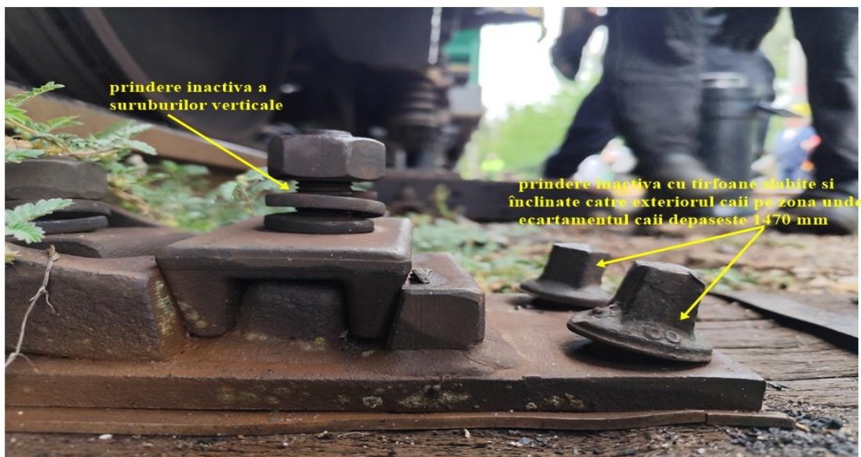
Foto nr.21 – prindere placă metalică – traversă inactivă
