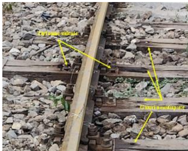
Foto.nr.6 – Tirfoane săltate, găuri neastupate
