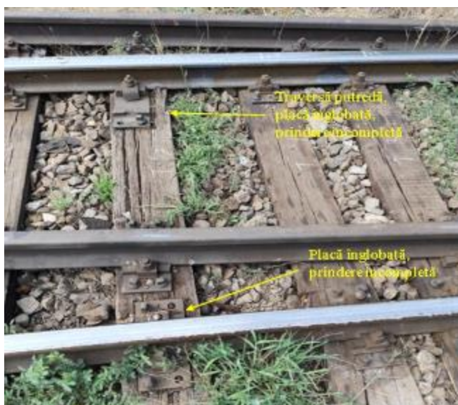
Foto nr.7 – Traversa T 5
