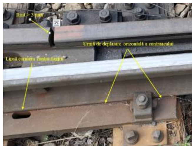
Foto nr.18 – Urmă deplasare laterală contraac
