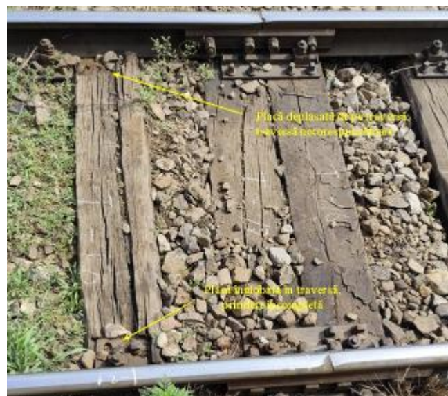
Foto nr.6 – Traversa T 18
