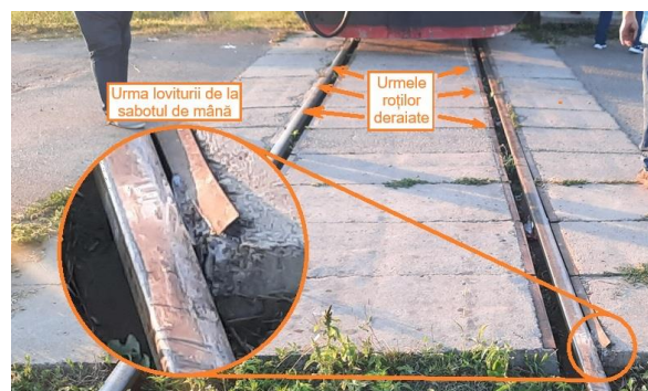
Foto nr.5 – Urme pe dalele pasajului
