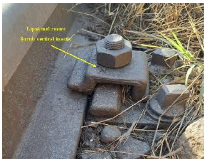
Foto nr.17 – Șurub vertical inactiv
