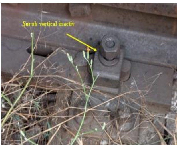
Foto nr.18 – Șurub vertical inactiv
