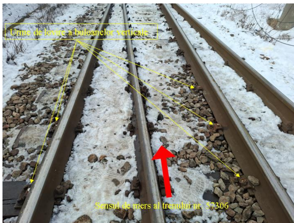
Foto nr.14 – Urme de lovire a buloanelor verticale pe zona șinelor de legătură a schimbătorului de cale nr.10
