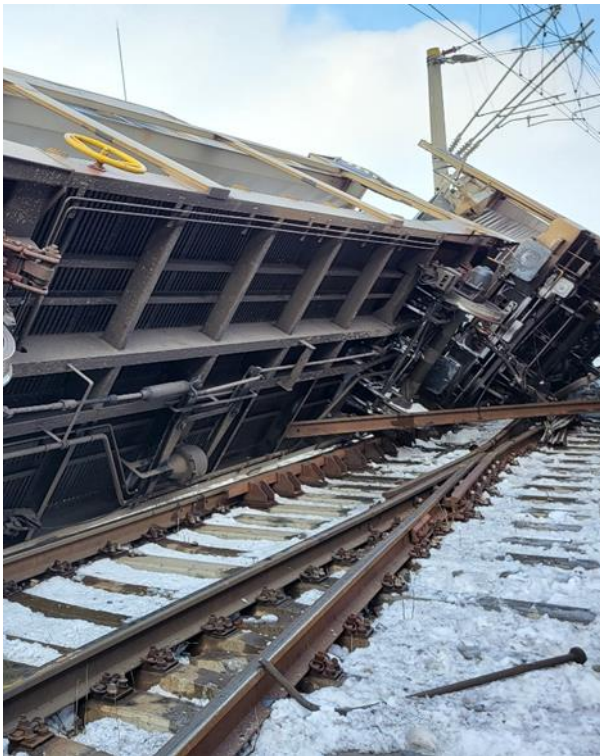
Foto nr.19 – Schimbătorul de cale nr.8 după accident
