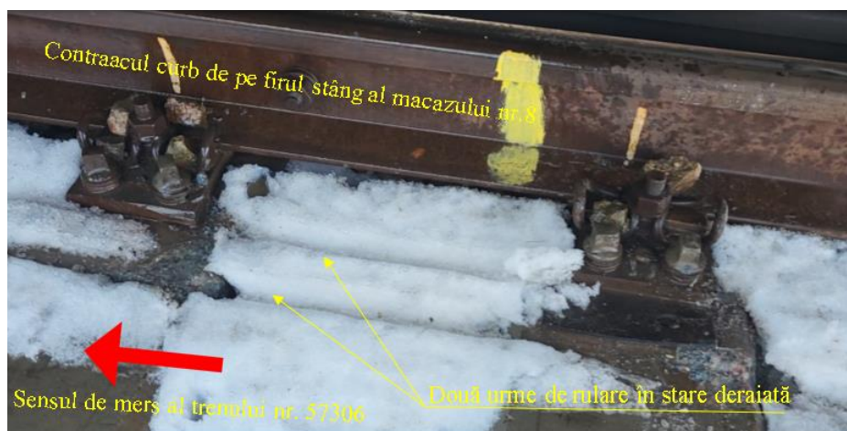
Foto nr.18 – Două urme de rulare în stare deraiată pe macazul schimbătorului de cale nr.8
