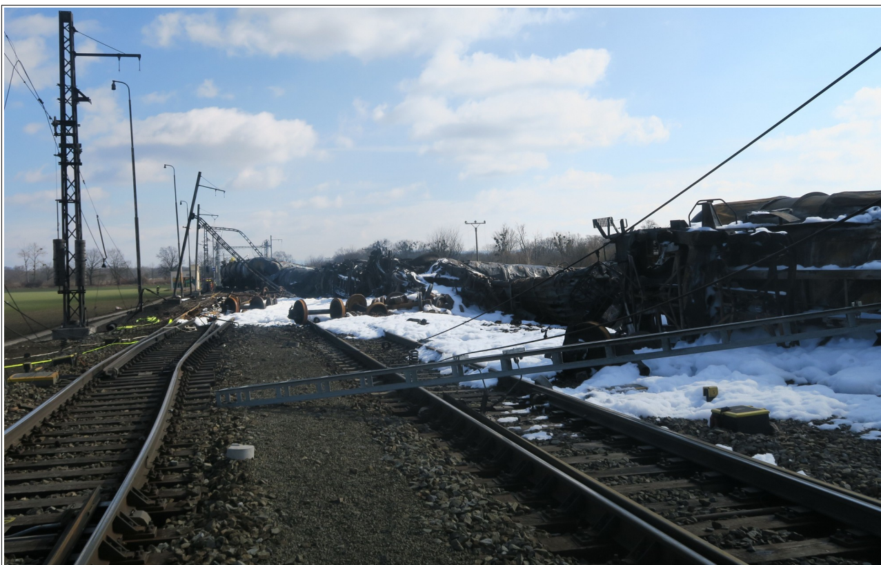
Obr. č. 33: Pohled od výměnové části výhybky č. 6 na místo MU a poškozenou infrastrukturu dráhy
