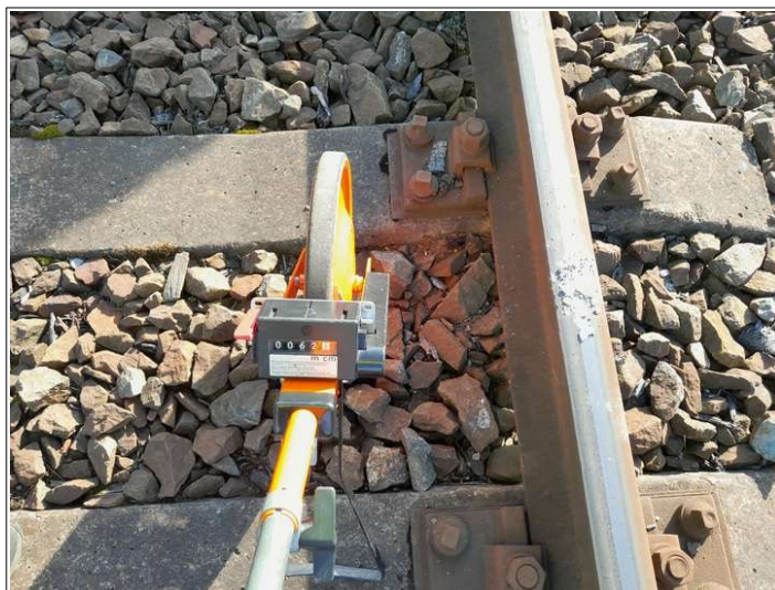
Obr. č. 2: Detail stop na pravém kolejnicovém pásu manipulační koleje č. 13 v žst. Planá u Mariánských Lázní
