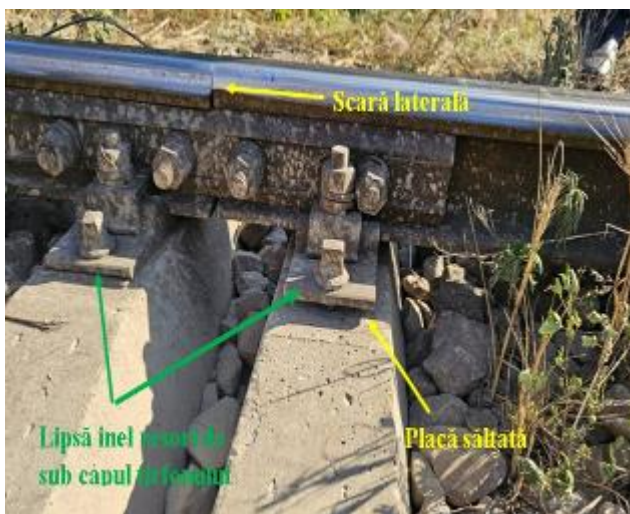
Foto.nr.13 – Placă ridicată la traversa de beton T13
