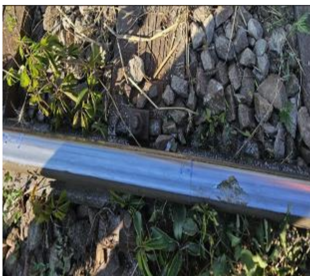
Foto.nr.18 – Pilitură pe talpa șinei și traversă
