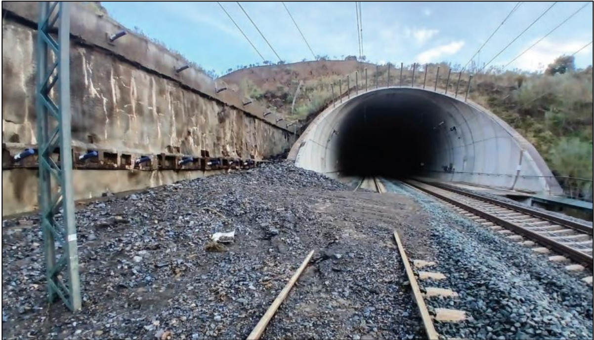
Figura 2 Situación final de la salida norte del túnel de Álora al día siguiente del suceso (Fuente ADIF)
