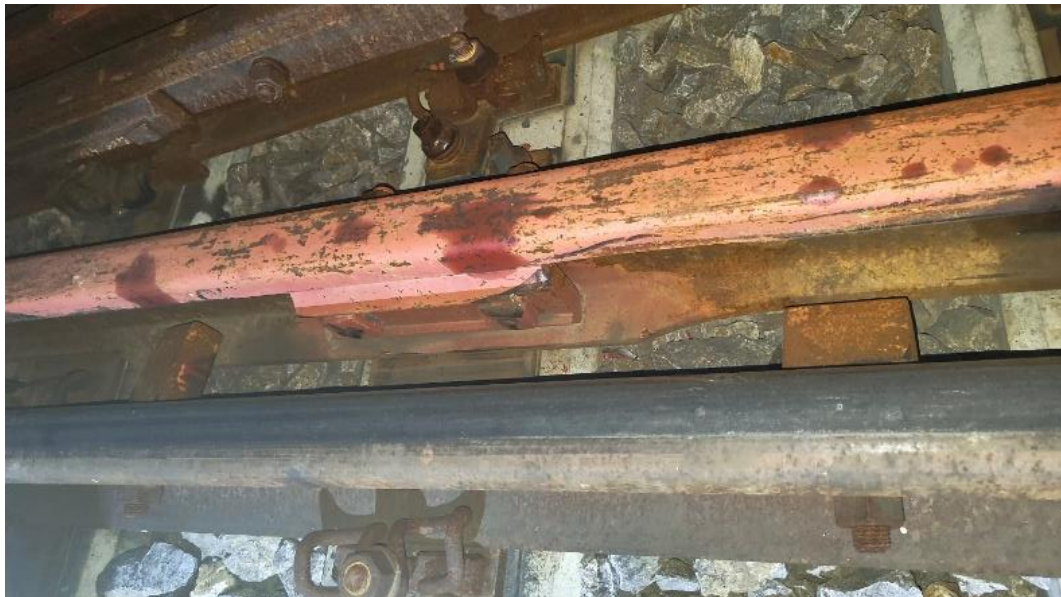
Foto. nr.10 – Urmă de lovire pe suprafața aripii acului drept din partea stângă a aparatului de cale
