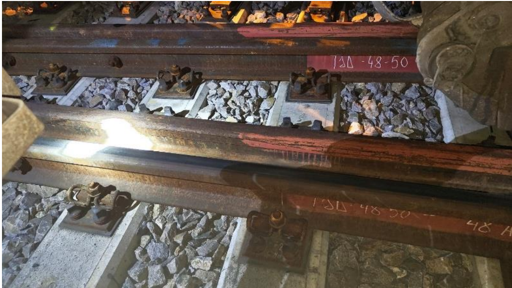
Foto. nr.11 – Urmă de rulare pe laterala acului drept și pe proțapii contraacului
