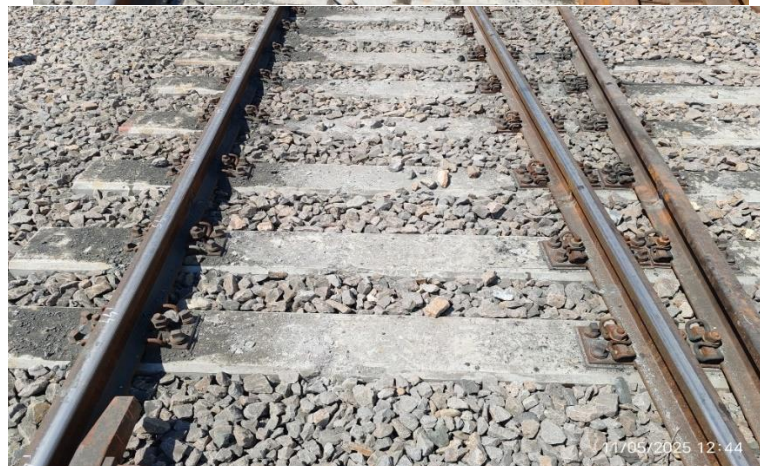
Foto. nr.12 și 13 – Starea traverselor aflate în cale și gradul de colmatare a prisme de piatră spartă
