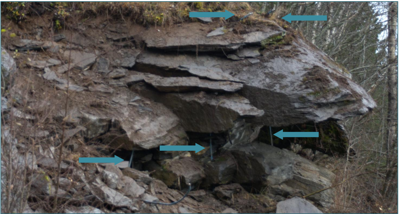
Figur 9: Rassted med de tre sikringsstagene markert. Foto: SHK
