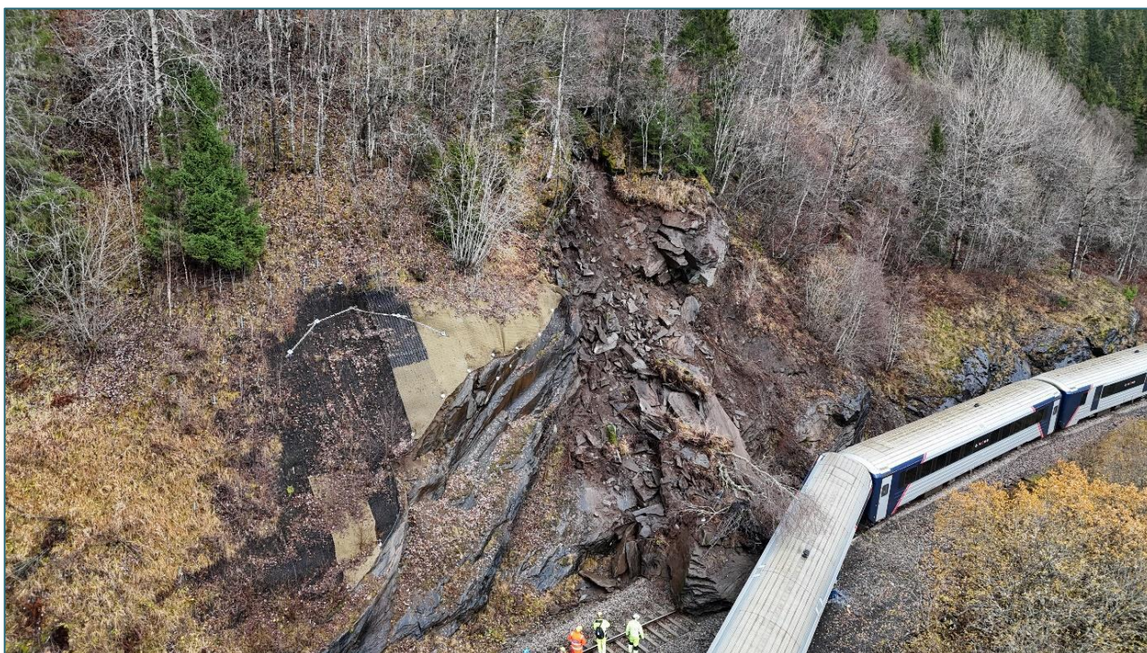
Figur 7: Området for steinskredet. Foto: Bane NOR SF
