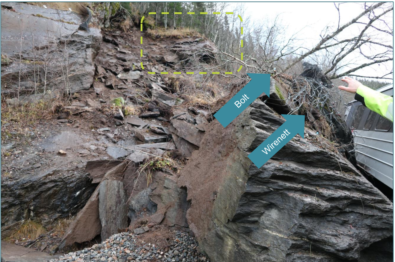
Figur 10: Steinblokken som falt ned med wirenett og deler av bolter og stag. Foto: SHK
