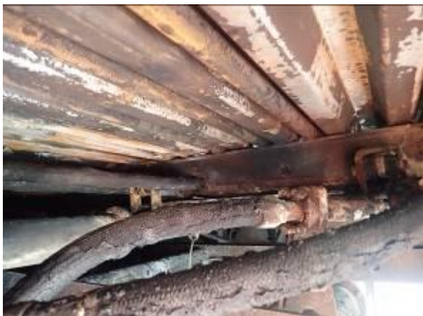
Foto nr.7- zonă afectată de incendiu
