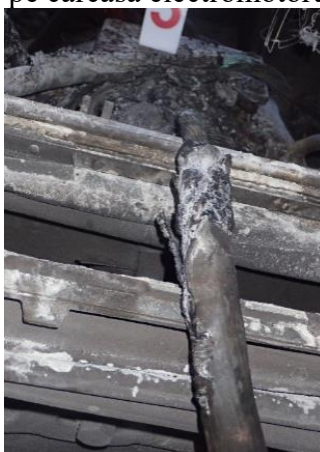
Foto nr.5 Burduful flexibil de legătură între canalul de ventilație și EMT nr.3
