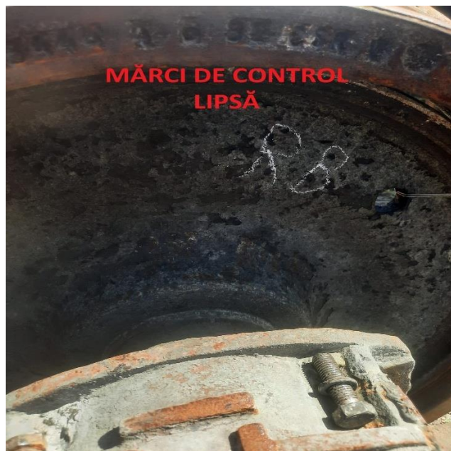
Foto nr.6 – R8, mărci de control lipsă;
