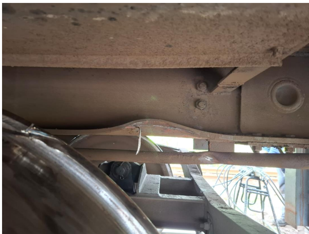
Imaginea nr.8 – urme pronunțate de lovire pe buza roții nr.2 (roată găsită pe șină nederaiată)
