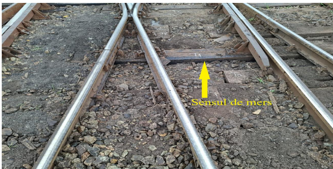
Imaginea nr.19 - suprastructura căii în zona punctului de deraiere
