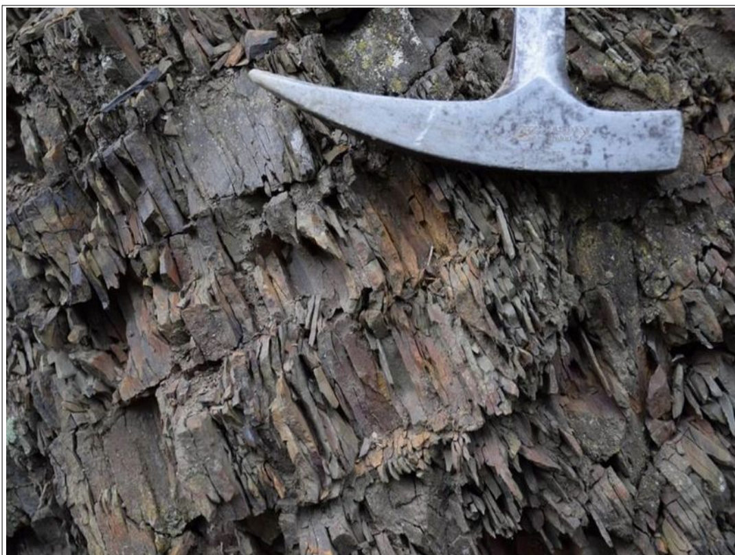
Obr. č. 6: Detail charakteru vrstev prachovců až prachovitých břidlic kosovského souvrství ve svahu odřezu jižně od místa skalního řícení. Dobře patrná je velmi hustá síť diskontinuit, zejména dominantní strmě ukloněné plochy vrstevnatosti se směrem kolmo k lici skalního svahu, které vymezují tenké destičkovité úlomky. Mimo vrstevnatost jsou patrné dva hlavní systémy diskontinuit protínající vrstevnatost (foto ČGS, 1. 7. 2022).
