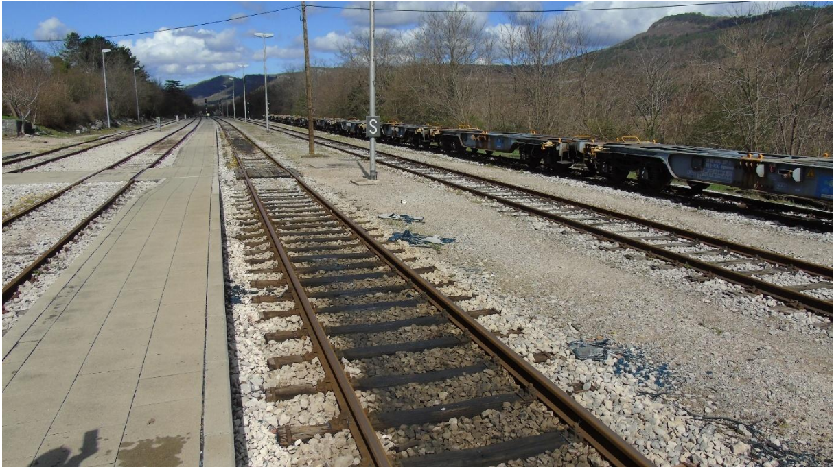
Slika 5. Treći kolosijek kolodvora Lupoglav s tragovima opožarenog vlaka (Izvor slike: AIN)
