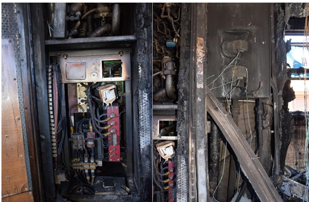
Slike 9. i 10. Opožareni prostor ormara S8 i ormara S9 (Izvor slike: MUP HR)
