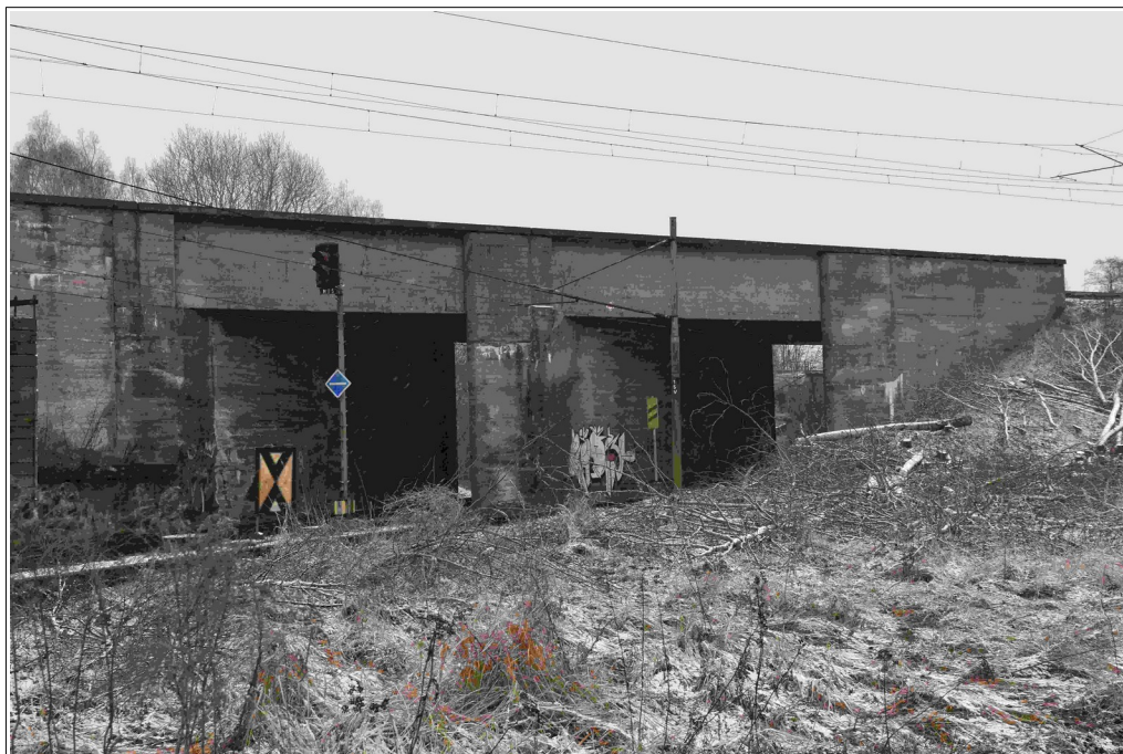
Obr. č. 6: Pohled na místo vzniku MU proti směru jízdy vlaku od koleje č. 100
