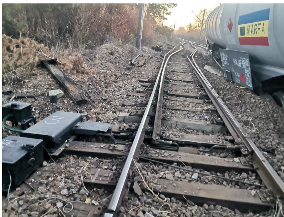
Foto nr.11 – Schimbătorul de cale nr.3 după deraiere
