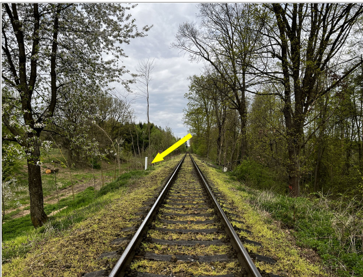
Obr. č. 5: Snímek z prostoru před místem MU dokumentující dne 23. 4. 2025 stromoví nacházející se v dopadové vzdálenosti do průjezdného průřezu TK Olbramkostel – Šumná, jež rostlo v porostním okraji pozemku p. č. 528/1, s vyznačením místa růstu stromu, jehož odlomená část koruny vytvořila překážku na dopravní cestě dráhy.
