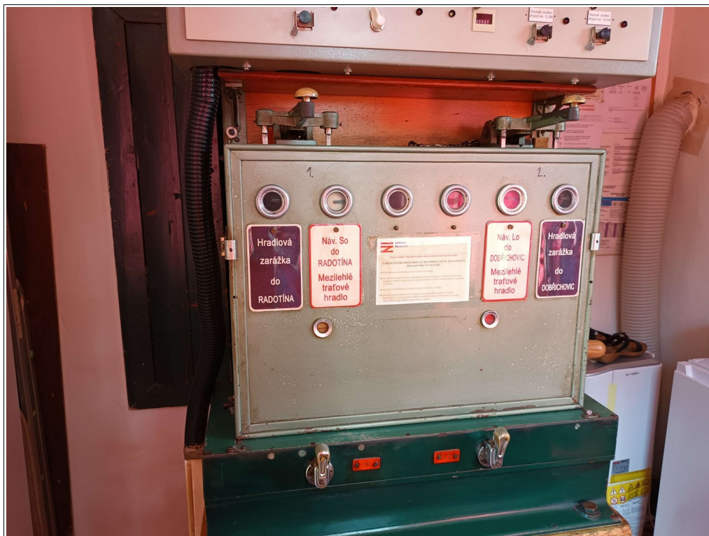
Obr. č. 3: Pohled na hradlový přístroj (elektrickou část stavědlového přístroje) hradla Kazín po vzniku předmětné MU Zdroj: SŽ
