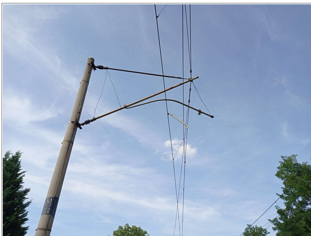
Obr. č. 4: Detailní pohled na poškození TV u TP č. 172 v km 15,410 Zdroj: SŽ
