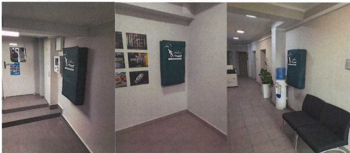
Materace ewakuacyjne: w budynku A, w budynku A1, w budynku B
