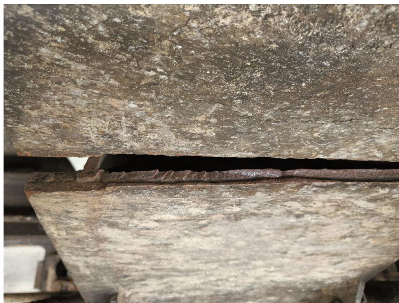
Foto nr.9 – Rupere la placa inferioară a traversei crapodinei în zona de îmbinare prin sudură
