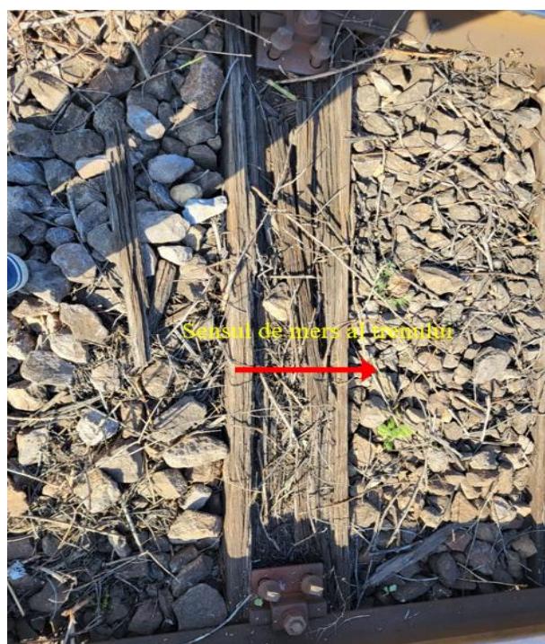
Foto. nr.12 – Starea tehnică a traversei T 15
