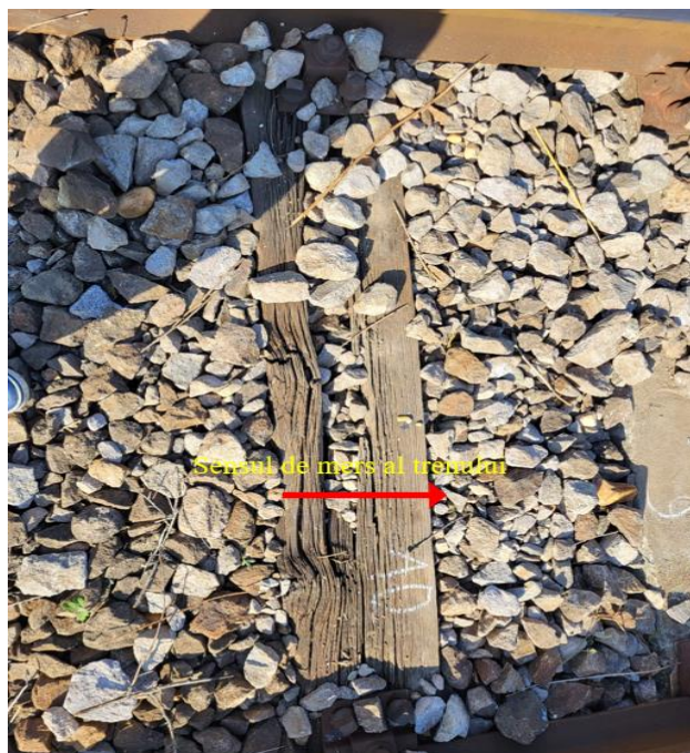
Foto. nr.10 – Starea tehnică a traversei T 10
