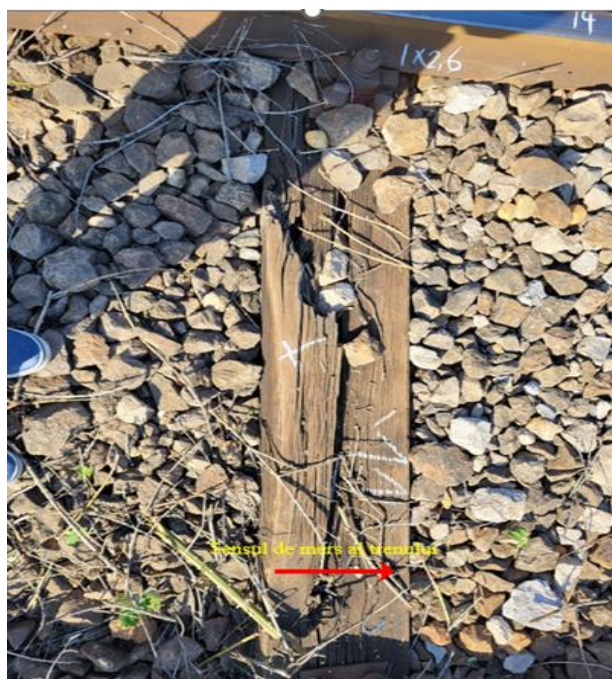
Foto. nr.11 – Starea tehnică a traversei T 11
