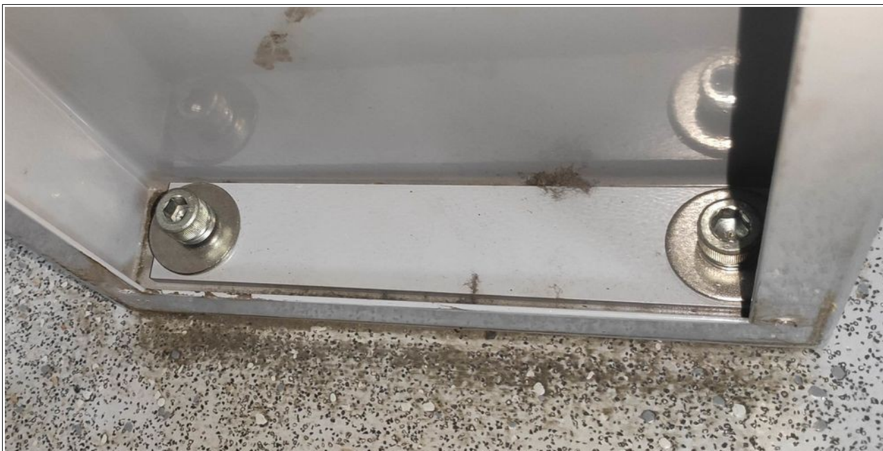
Obr. č. 7: Ocelová podložka (roznášecí plech) vložená do paty stojny sedačky, doplněná pérovou podložkou a kruhovou podložkou v HDV 813.201-1 dne 31. 7. 2025
