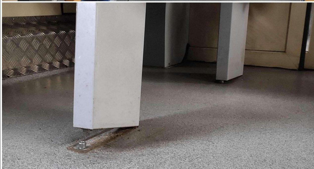
Obr. č. 4: Úplné vyvrácení dvojseďky (nahore), částečné vytržení stojin konstrukce sedaček z uchycení v podlaze (dole) Zdroj: DI
