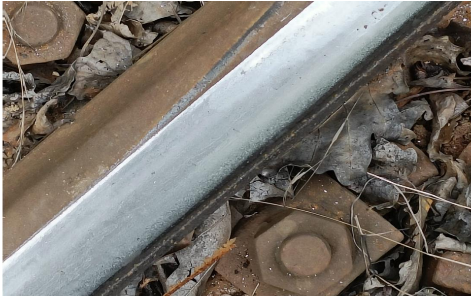
Foto nr. 3 – urmă de rulare a buzei roții pe suprafața de rulare a șinei
