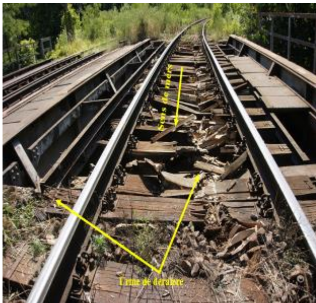
Foto nr.10 – Urme de deraiere
