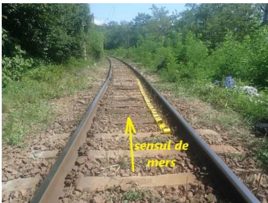
Foto nr.1 – zona producerii accidentului
