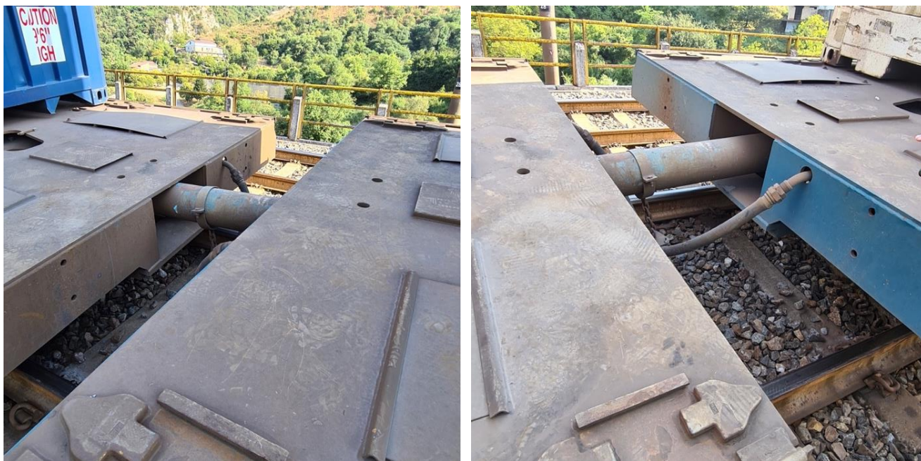
Figura 27 – Particolare dell'attacco rigido dei due moduli del carro n.8 (fonte: Ufficio).
