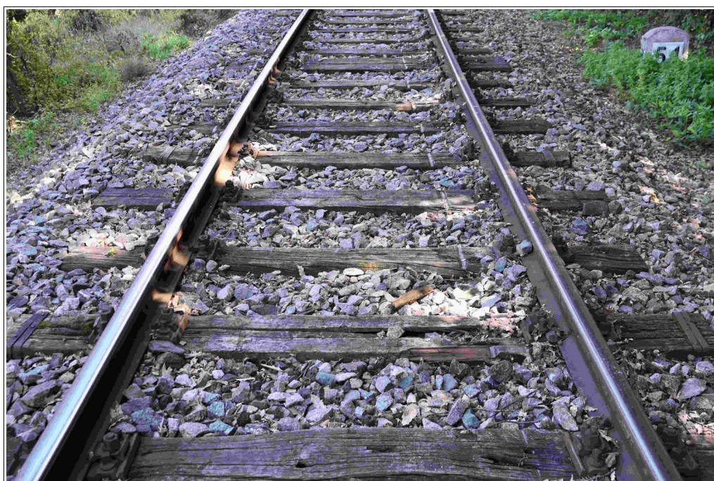
Obr. č. 6: Stav svršku v místě vykolejení
