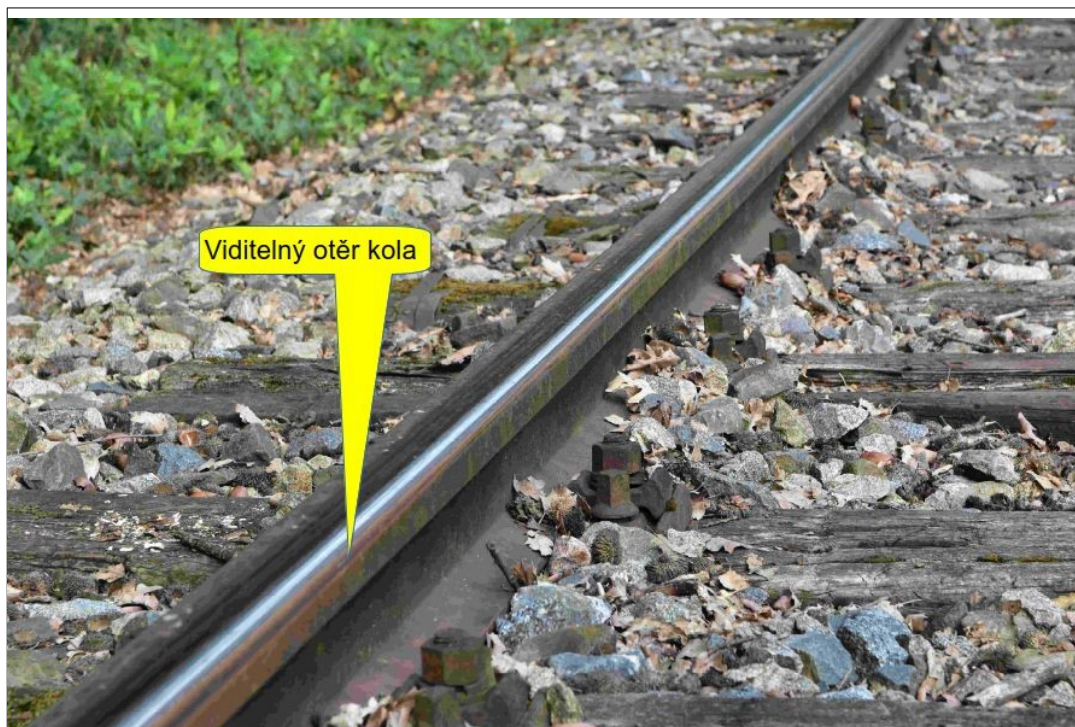
Obr. č. 5: Stav pražců na pravém kolejnicovém pásu 2 m před místem vzniku MU s viditelným otěrem po jízdě kola po vnitřním boku hlavy kolejnice (vlevo dole, pohled proti směru jízdy vlaku). Šetřením se nepodařilo prokázat, zda otěr vznikl v nezjištěné době před vznikem předmětné MU, nebo jako následek vykolejení vlaku Os 4583.
