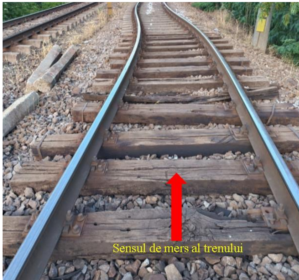
Foto nr.2 - Deformația transversală văzută din sensul de mers al trenului
