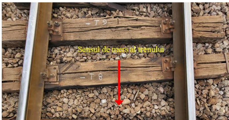
Foto nr.9 - starea tehnică a traverselor T-9 și T-8
