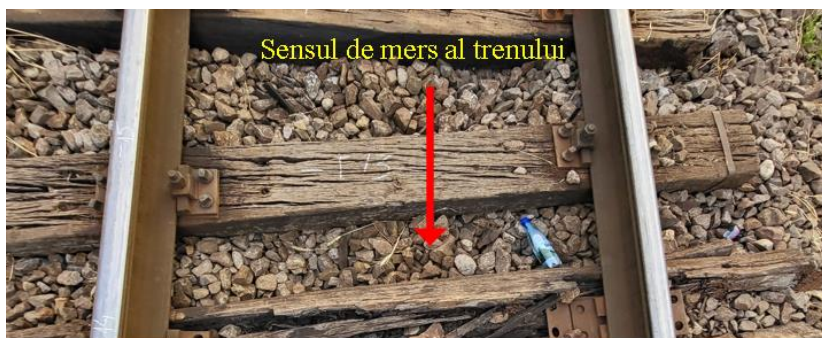
Foto nr.6 - starea tehnică a traversei T-13
