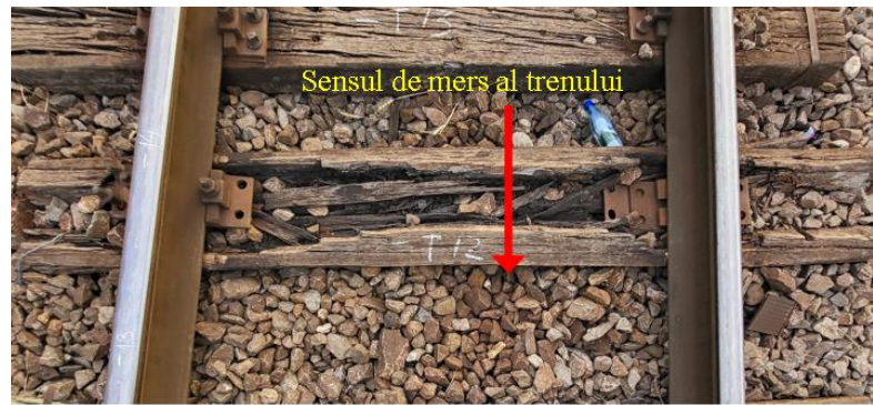
Foto nr.7 - starea tehnică a traversei T-12
