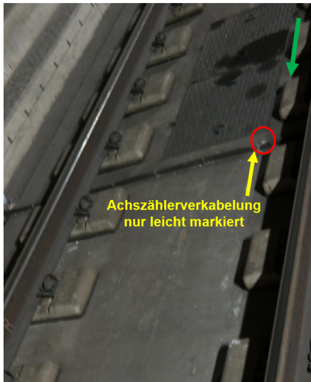
Abbildung 51: Leichte Markierung der Hülle der Achszählerverkabelung ohne Kabelschaden (Abschnitt 7705).
