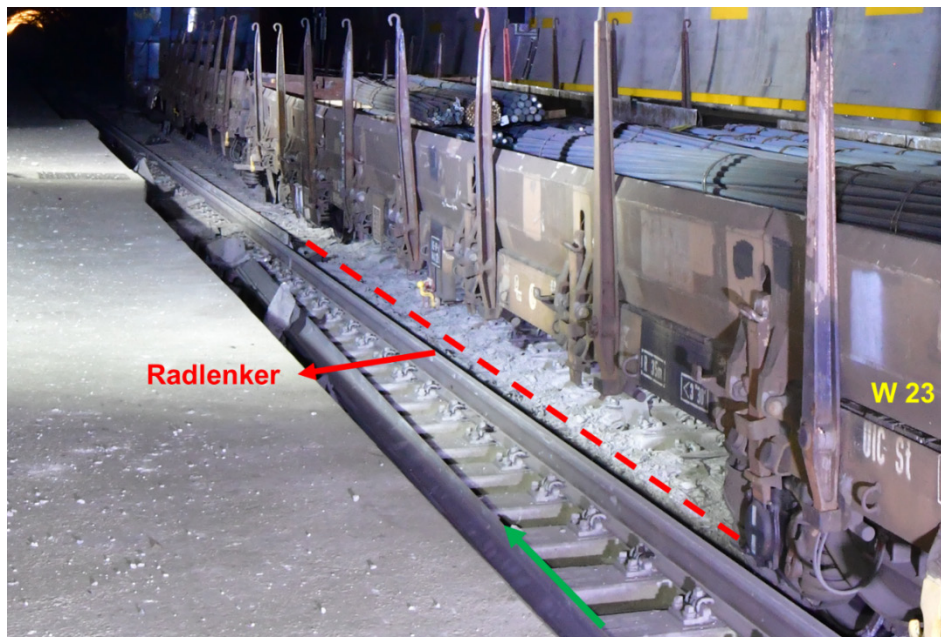
Abbildung 47: Abgerissener Radlenker auf der linken Seite des beweglichen Herzstücks der Weiche W386 (Quelle: Kapo TI, Ergänzung SUST).
