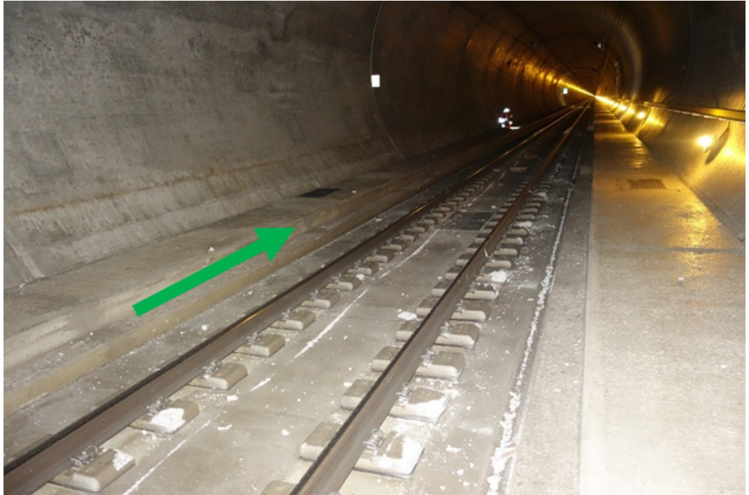
Abbildung 42: Schleifspuren auf dem Betonboden vom Spurkranz des linken Rades der Achse 1, Wagen 11. Beidseitige Beschädigungen an den Betonschwellen (km 46.60).
