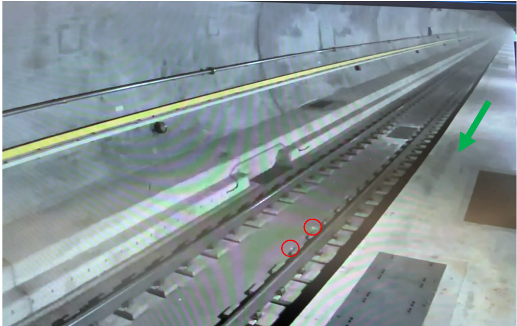
Abbildung 53: Gleiszustand nach der Zugdurchfahrt in der MFS Faido (ca. km 40.8). Die roten Kreise markieren die Spuren auf dem Betonboden. (Quelle: Bild aus der Videoüberwachung der MFS Faido der SBBI).
