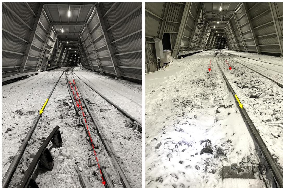
Figur 7 visar den första växeln i Vassijaure med skadorna närmast före korsningspartiet. Vidare visas spår 1 efter växeln med märken efter hjul till höger om spåret. Tågets färdriktning och den högra rälens markeras med gula pilar.
