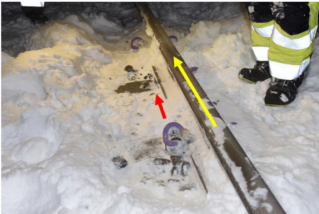
Figur 5 visar den första skadan på rälsbefästning innanför den högra rälen i tågets färdriktning. Den röda pilen markerar skadan och den gula pilen tågets färdriktning.
